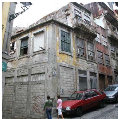
Edifícios em ruína da Rua da Bainharia parcelas 16 a 19/19A
