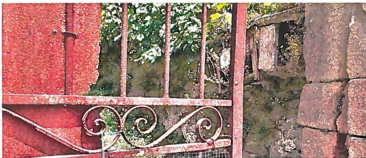
Figura 2 – Pormenor de edifício em ruína - ARU Campanhã-Estação
