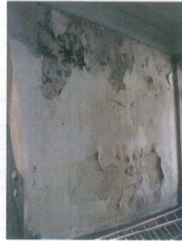
Fig. 14- Perspectiva interior – infiltrações e descolamento do reboco
