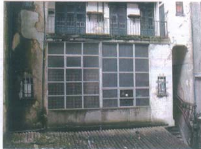
Fig.5 – Deterioração e desagregação do reboco
