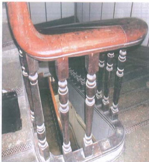
Fig. 10– Balastrada – elementos em falta
