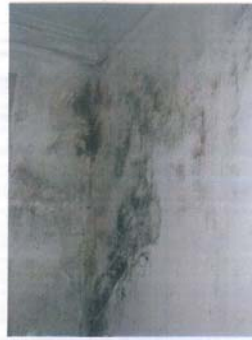
Fig. 12- Perspectiva interior - infiltrações
