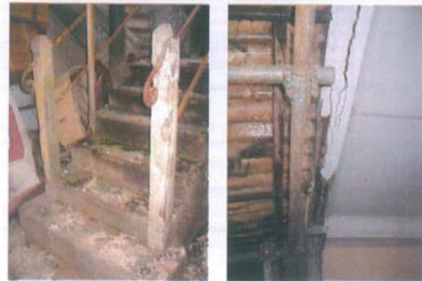
Fig.8 – Deterioração da construção
