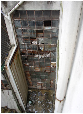
portas e janelas caixilhos: caixilho: deformação, empeno, corrosão
