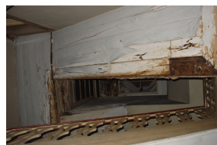
estrutura em madeira e estabilidade dos pisos superiores: risco de ruína e desabamento
