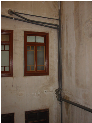
redes de águas residuais – saneamento, rede no interior do edifício: mal funcionamento devido ao traçado e curvatura da tubagem
