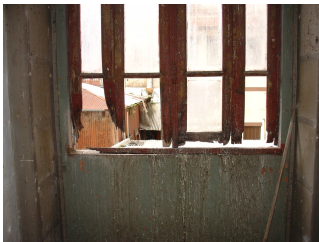
caixilho: degradação e rotura
