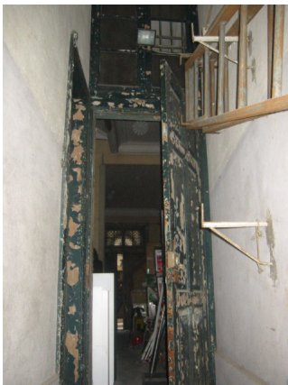
caixilho – pintura: escamação
