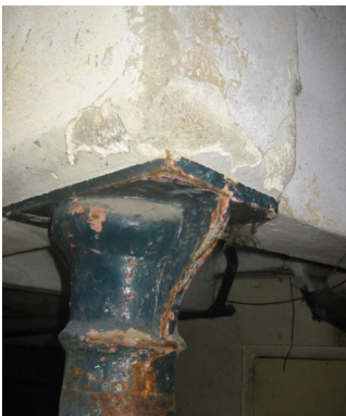
estrutura metálica, elementos estruturais metálicos: corrosão
