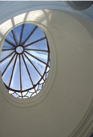
clarabóias, caixilharia: falta de estanquidade pintura: efluorescência
