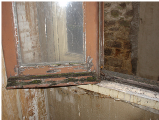
caixilho: deterioração, escamação, folga nas juntas móveis
