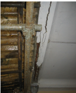
estrutura de betão armado, viga - armadura : degradação e corrosão
