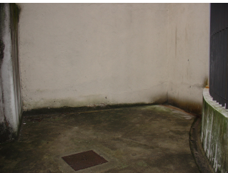
ralos, caleiras e algerozes: caleira, algeroz: entupimento, rotura, fuga
