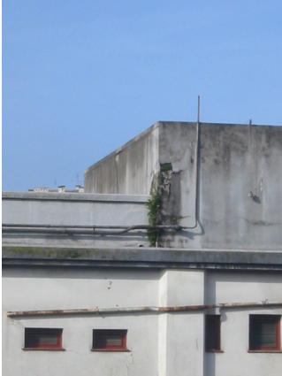
coberturas inclinada, beirado: vegetação infestante
