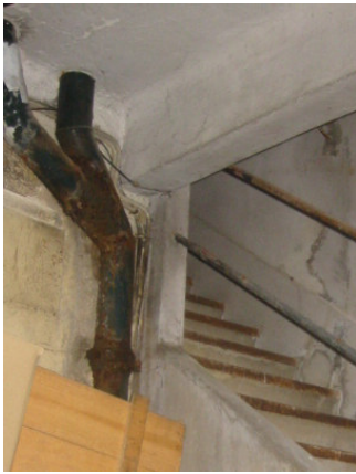
tubo de queda da rede exterior do edifício: corrosão e deterioração
