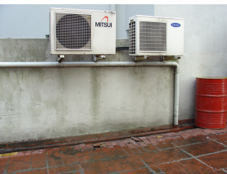
revestimentos com mosaicos cerâmicos: impermeabilização – revestimento com mosaico: quebra, descolagem
