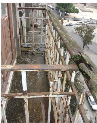
varandas, guarda em ferro: corrosão
