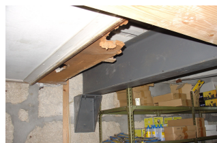
estrutura de madeira: no primeiro piso do edifício a estrutura em madeira foi reforçada com uma estrutura metálica - insuficiente
