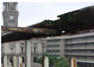
varandas, corrimão: deterioração, degradação, envelhecimento da madeira
