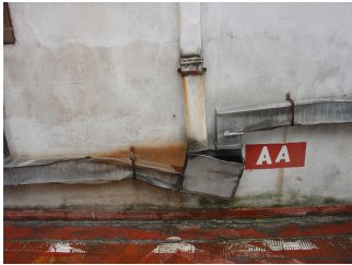
tubo de queda da rede exterior do edifício: deterioração e degradado
