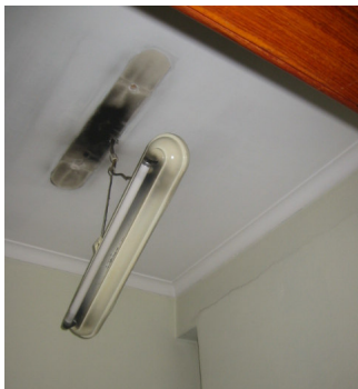
redes eléctricas, blocos de iluminação: risco de incêndio e choque eléctrico
