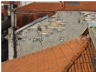
revestimento em lousa: degradação
