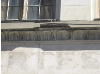
parapeito – revestimento: degradação e corrosão
