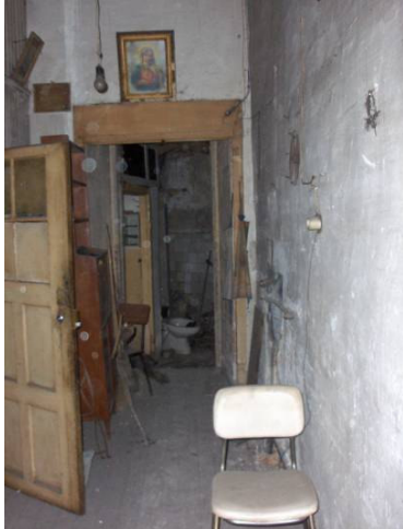
Interior degradado de um dos prédios da Rua de Sá da Bandeira (P4)
